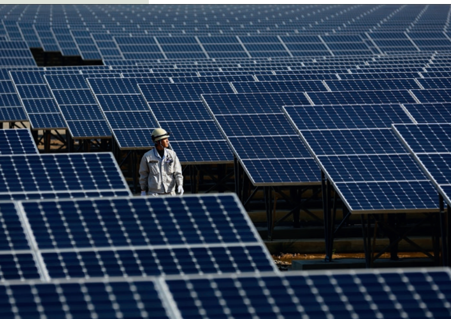
Centrale solaire de Nanao, au Japon.
