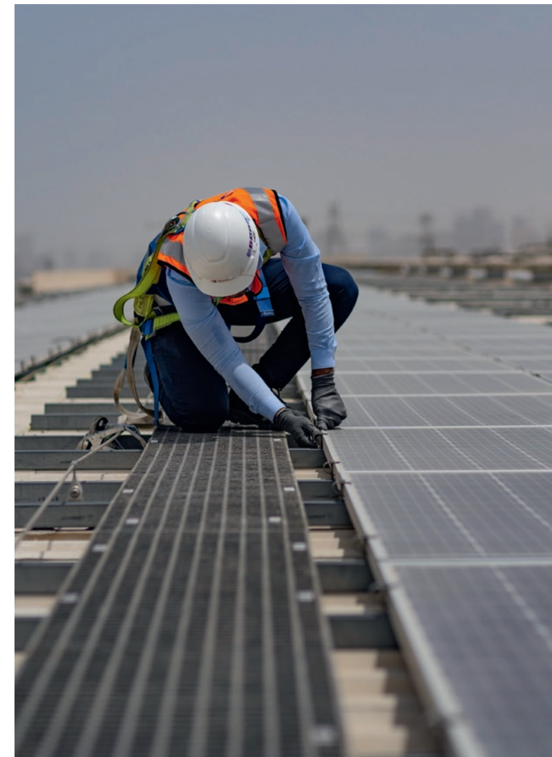
Entretien de panneaux solaires posés sur le toit d'Emirates Glass, à Dubaï.
